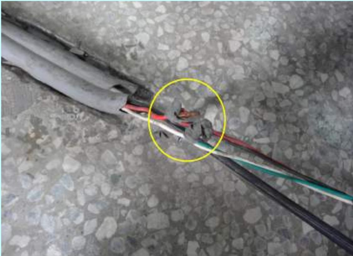
照片 2 地面插座電線裸露之情形
